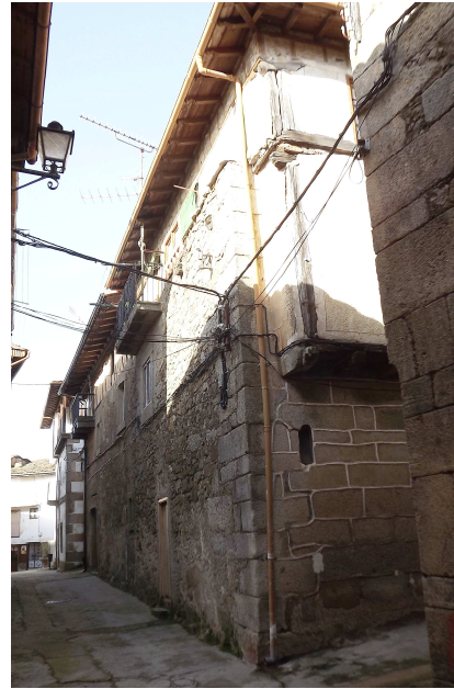
EJEMPLO 1: Modelo primitivo con un solo cuerpo volado macizo y entramado visto solo en esquinas y forjados. Excepcionalmente la piedra llega a la segunda planta en la fachada principal, por lo que no puede descartarse un recrecido posterior al origen.
